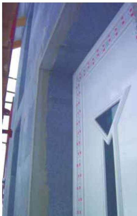
Ściana ocieplona 34-centymetrową warstwą izolacyjną TERMO-LAMBDA oraz drzwi ciepłochronne w budynku pasywnym
