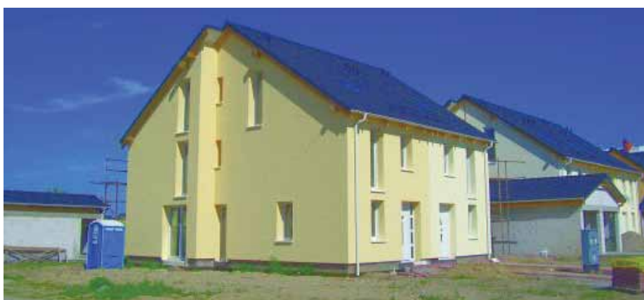
Budowa domu bliźniaczego pasywnego Gdańsk-Homera
