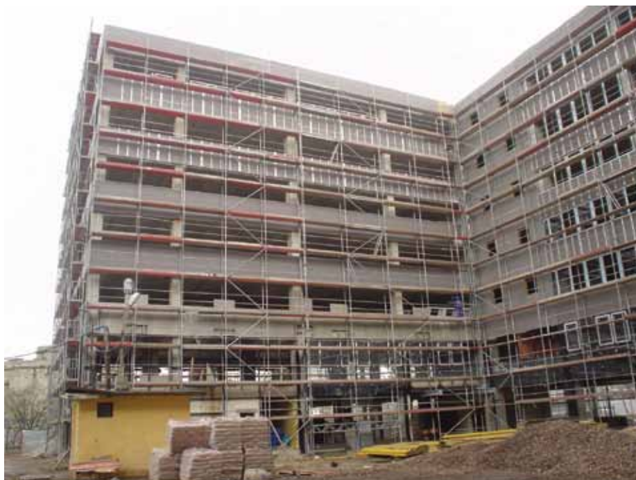
Silver Forum Wrocław - ukończony budynek na poprzedniej stronie, - prace montażowe powyżej. Ściany osłonowe wykonane w technologii SUNDAYsystem™
