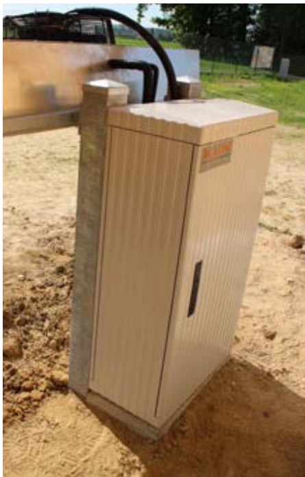
Fot. ACALOR: Szafa rozdzielacza
